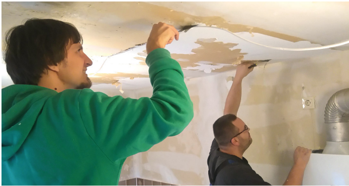
Die Tapeten in der Küche wurden vor 40 Jahren gut verklebt. Philip Kanthäuser und Carsten Wimmer (v.l.) haben nicht aufgegeben.
